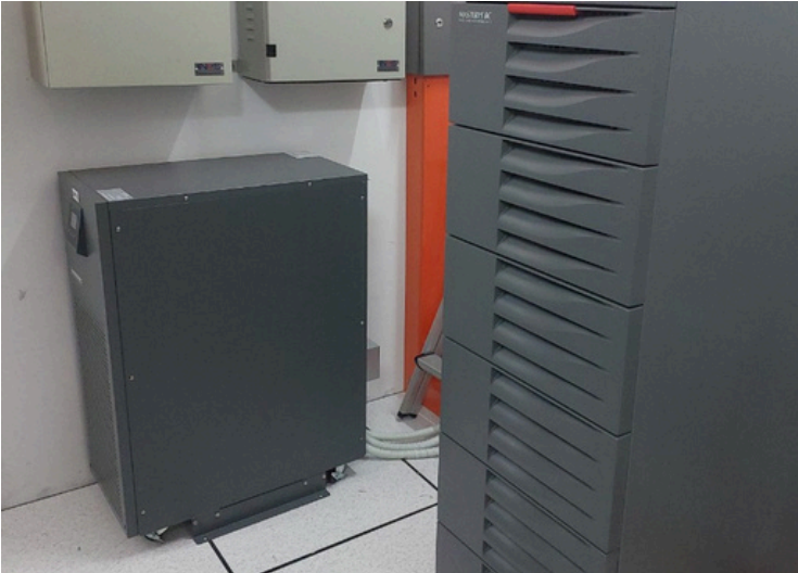
LẮP ĐẶT PHÒNG SERVER
